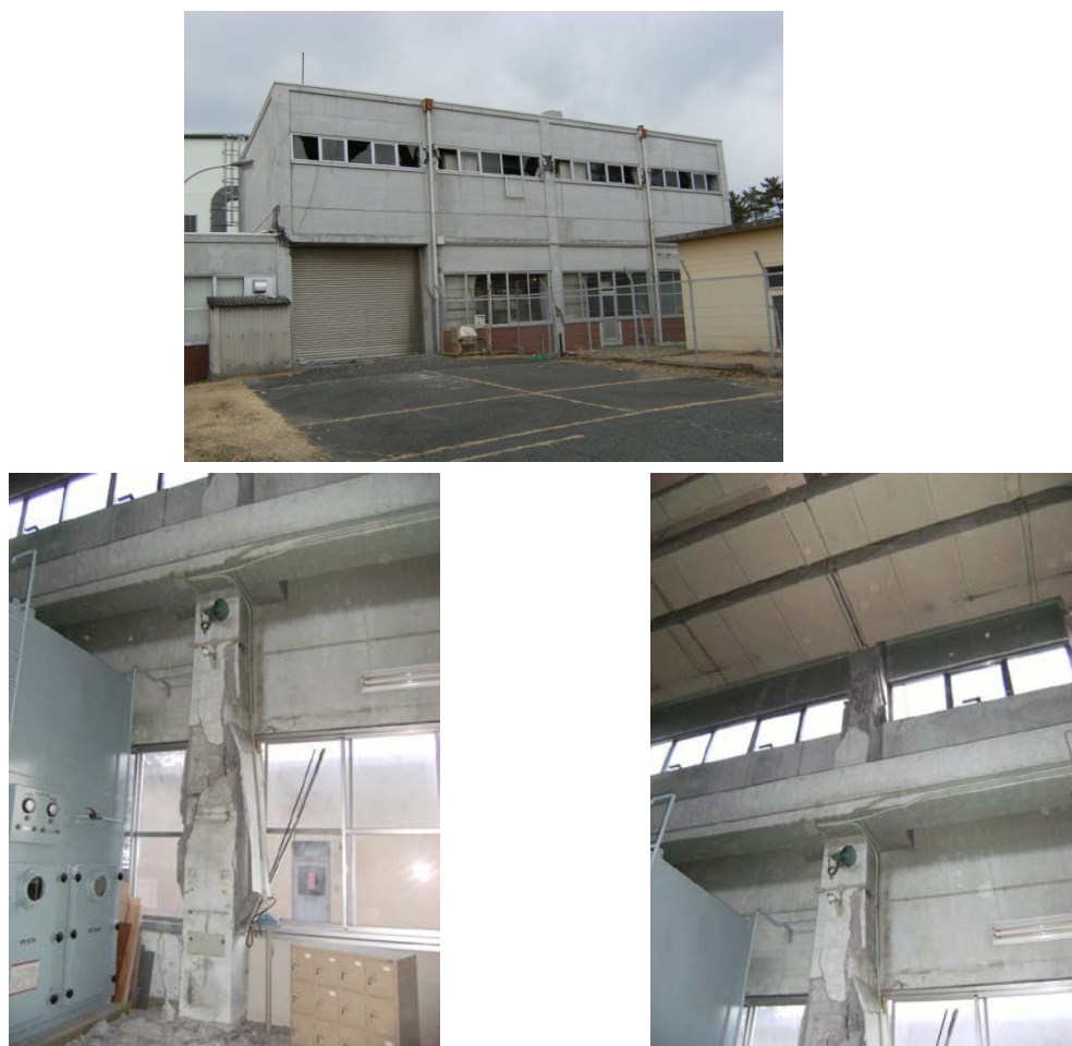
図 3.1.4-2 15ton クレーン室の被害状況
