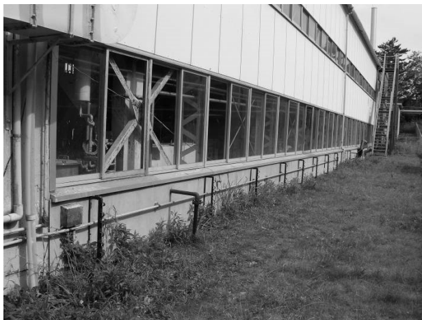
図 3.1.5-3 液体処理場の応急処置後の状況
