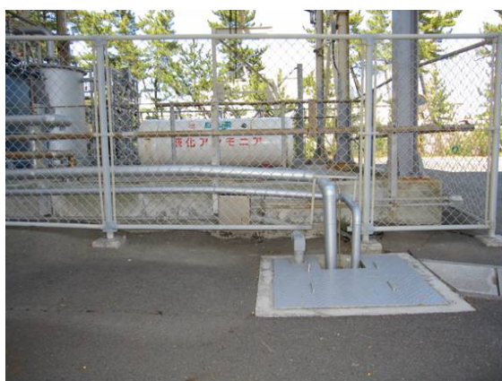
LPG 配管等の変形
