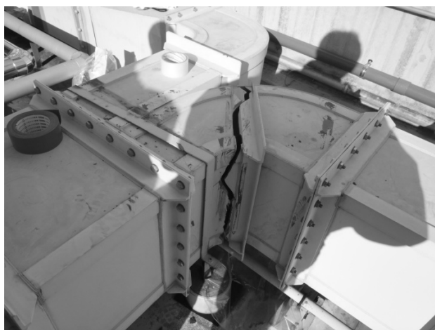
図 3.1.5-4 汚染除去場の屋外排気ダクト被害状況
