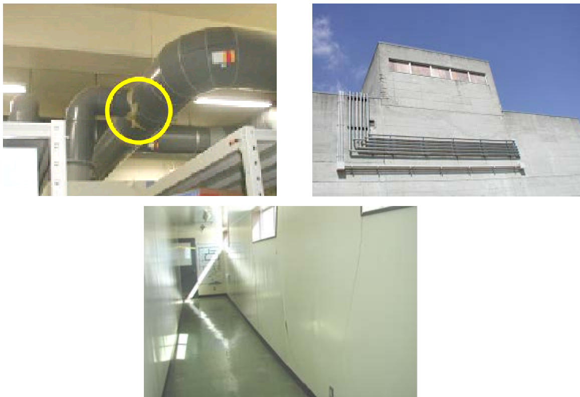
図 3.1.5-2 バックエンド技術開発建家の被災及び復旧の状況
