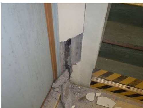
143 号室・Ⅲ棟とⅣ棟の接合部壁 亀裂（はく離）状況
