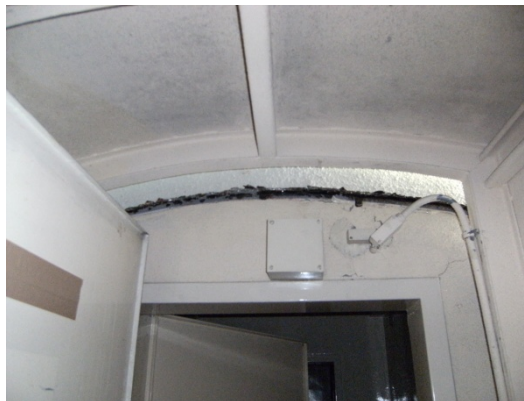
図 3.1.4-3 燃料貯蔵庫の建家の被害状況 (つなぎ部の隙間状況 (建家内部))
