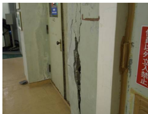
133 号室・Ⅲ棟とⅣ棟の接合部壁 亀裂（はく離）状況
