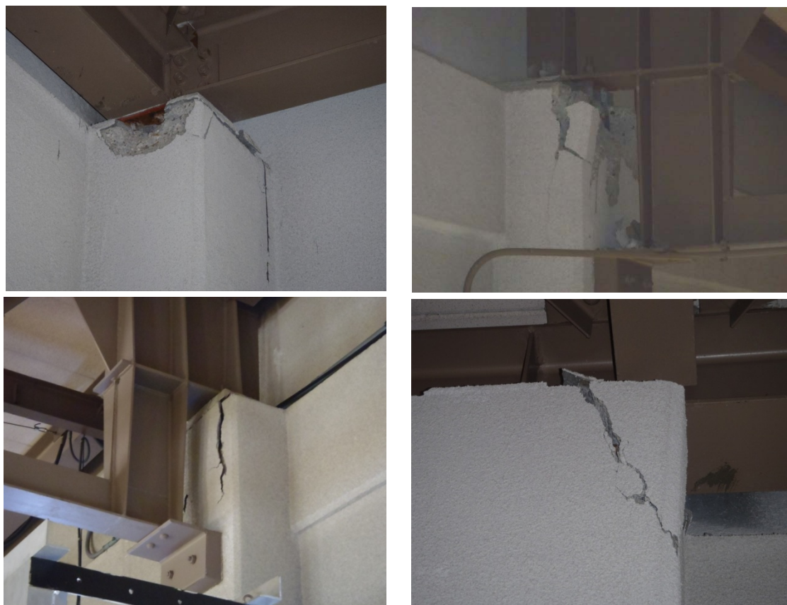
図 3.1.1 第2廃棄物処理棟支柱上部の被害状況
