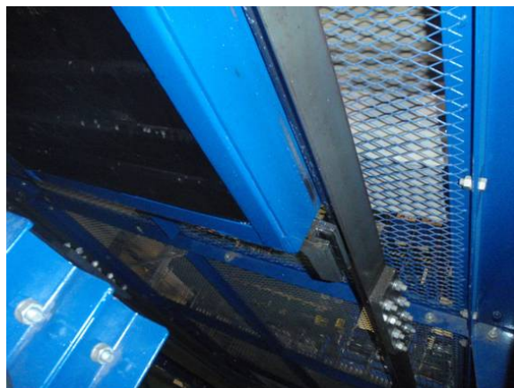
図 3.1.2-2 減容処理棟の建家内の被害状況 (一時保管設備垂直搬送機カウンタウエイトの脱線)
