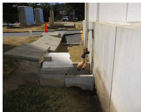
重油配管 2 本の破断
