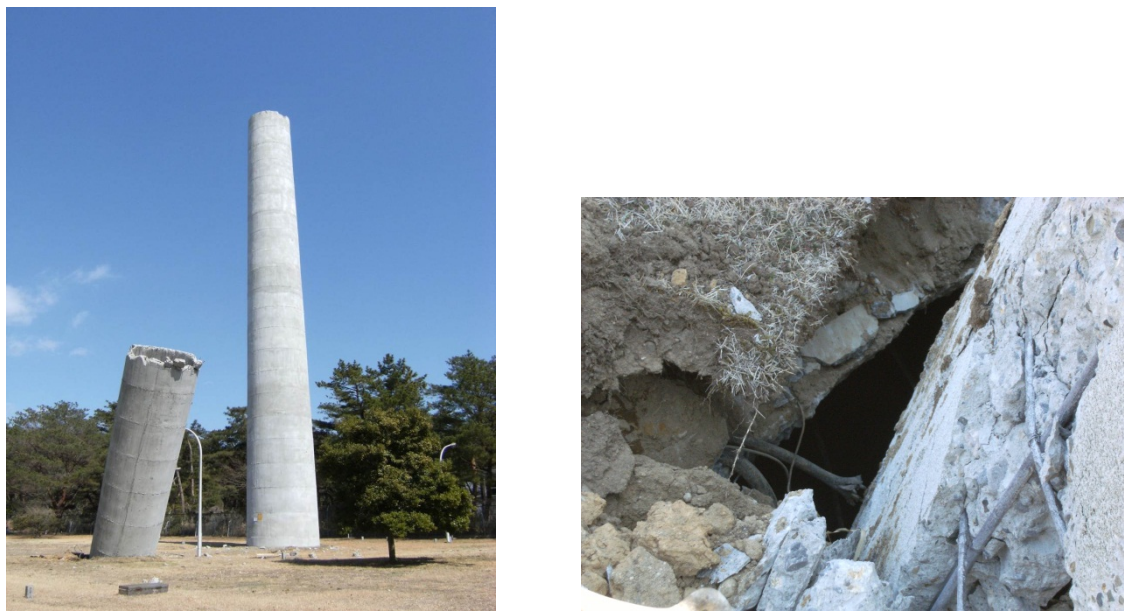
図 3.1.4-1 JRR-2 の排気筒(左)及びコンクリートダクト(右)の被害状況
